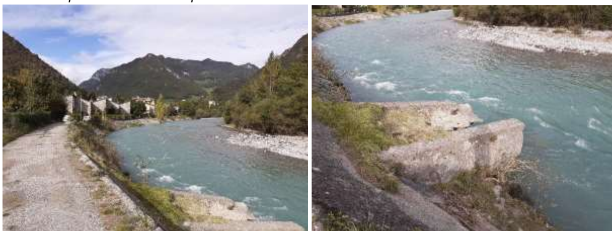
Il tratto di difesa spondale in località Festi Rasini. Sul fondo le villette evacuate. A destra particolare del pennello danneggiato.
